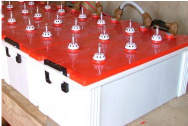
4 x 12 volt 200 amp hour Battery bank
