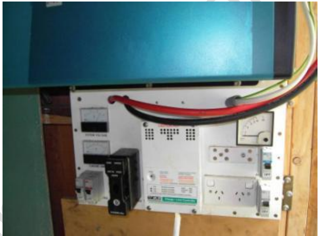
Small 24 volt system
